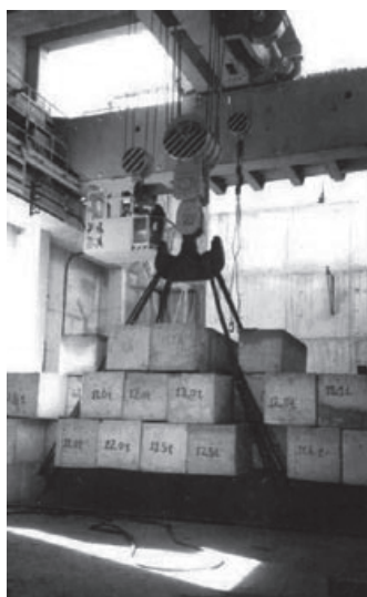
Мостовой монтажный кран 200/15/15 т на ГЭС «Диар Эль Уэд» (Марокко)
