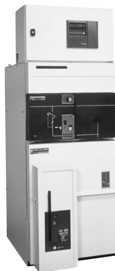
Рис. 4: Пример применения ЭМС: SM6 панель среднего напряжения, содержащая токовый выключатель, предназначенный для прерывания мощности (сотни ампер и десятки киловатт), и прибор СЕПАМ- программируемое средство управления, мониторинга и защиты. Полная сборка должна оставаться действующей при любых обстоятельствах.
